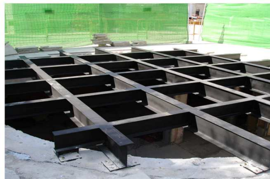
Estructura metalica de IPN
